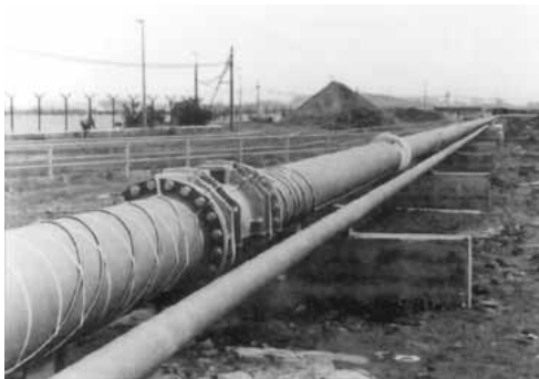
Рис. 2.18. Парафинопровод на нефтеперерабатывающем заводе
