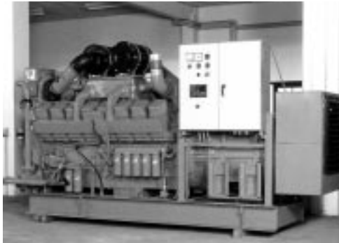
Рис. 4.3. Агрегат резервного энергоснабжения (тип CS-1000/50)
